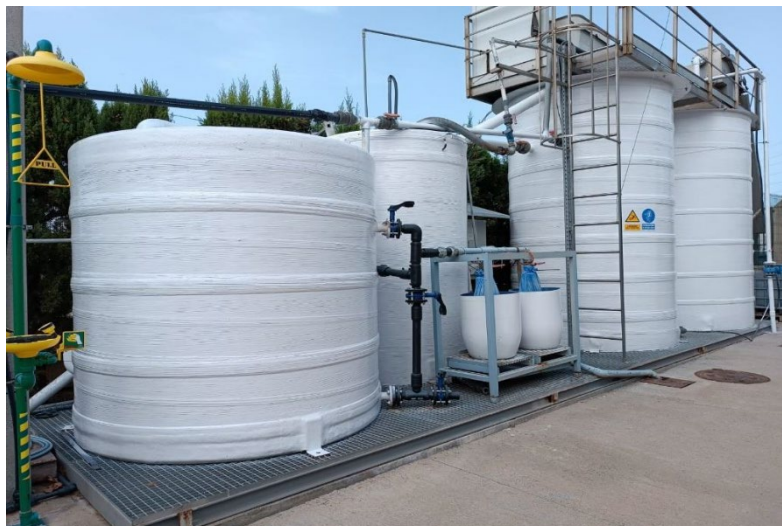
Ilustración 2: Estación depuradora de las granjas de la UPV.
