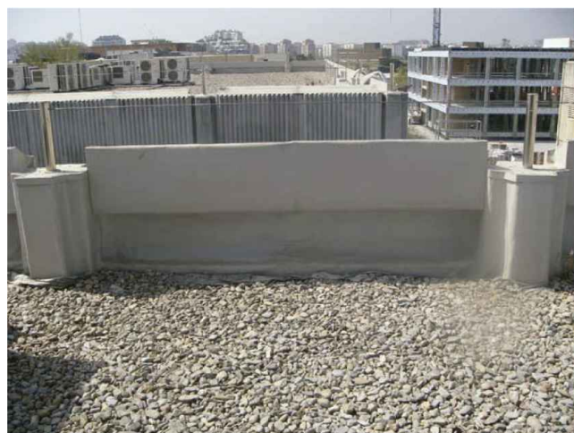
IMAGEN 1 ANTEPECHO: ESTADO ACTUAL
