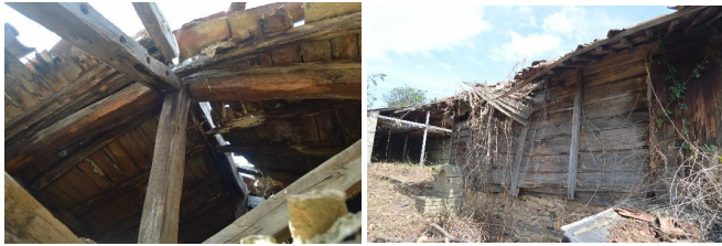
Imagen 9 y 10, lesiones en cubierta y cerramientos.
