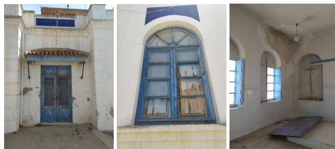
Imagen 11. Patologías en carpinterías y espacios interiores
