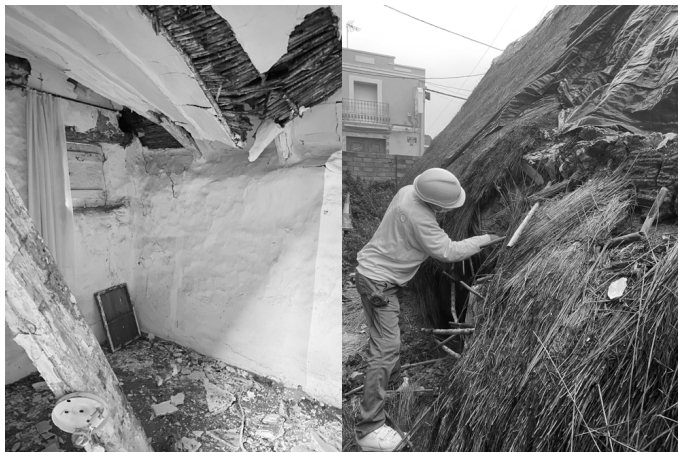
Imagen 3. Imágenes del estado inicial de la barraca antes de la restauración. Fuente: Ramos Furió, C.
