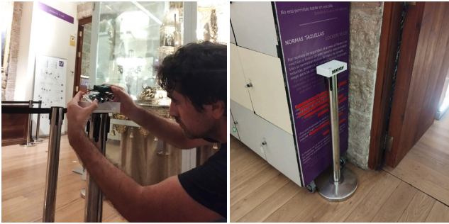
Imagen 5, y 6. Proceso de instalación de los sensores y sensor instalado en el Ingreso del Museo.
