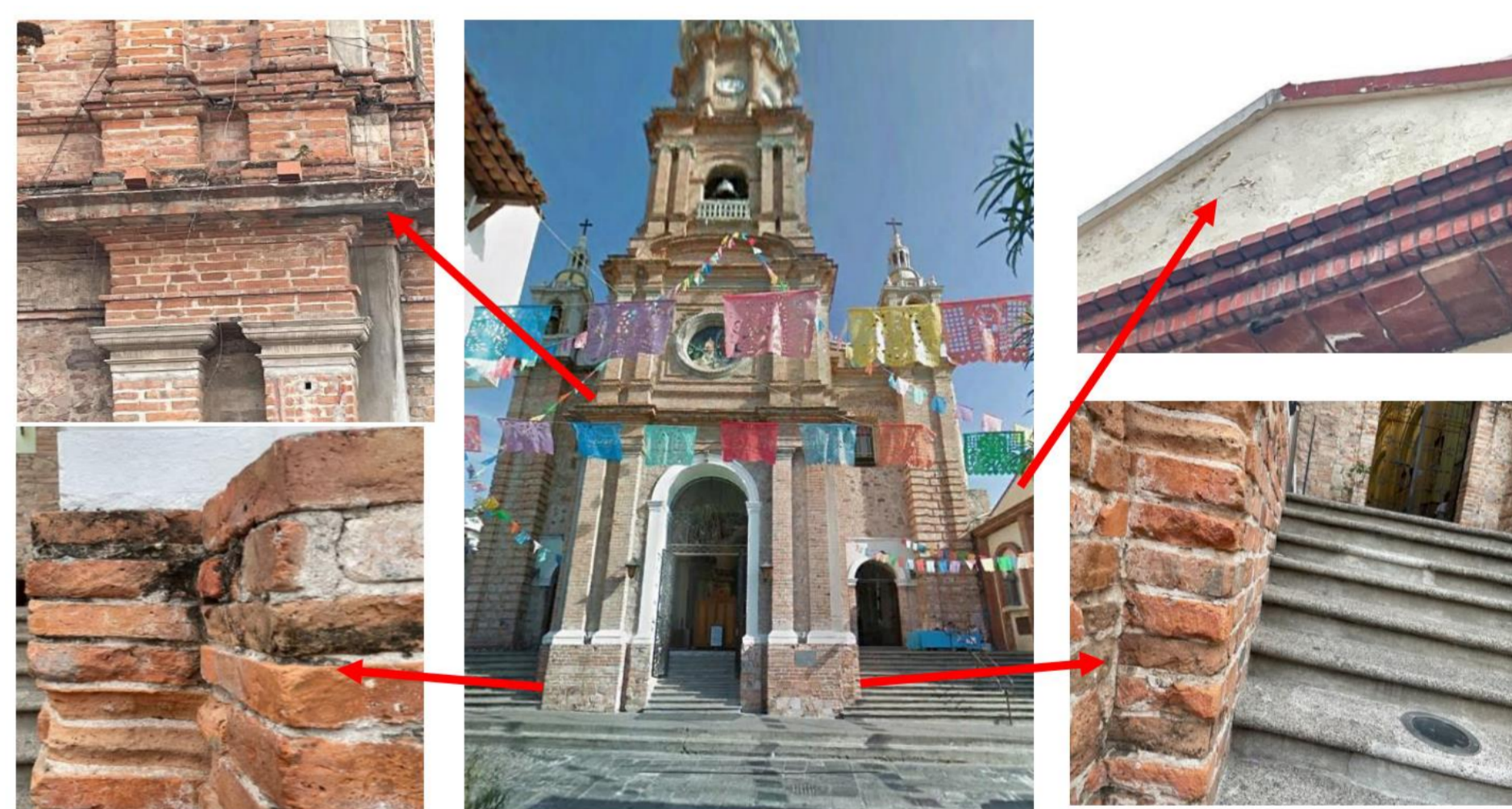
Imagen 2. Patologías por humedad por capilaridad filtración y erosión/ Pathologies due to humidity due to capillarity, filtration and erosion
