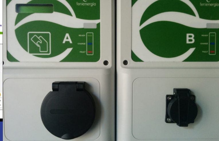
Dotación de comunicación a los postes de carga de vehículos.
