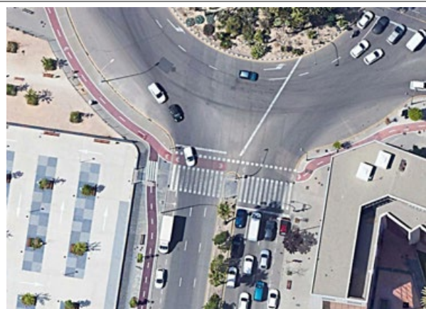
Paso de peatones (nº 10). Paso de peatones en dos tramos que cruza la calzada, regulación semafórica. Señalización horizontal en todos los tramos, aunque la pintura de señalización está bastante borrada.
