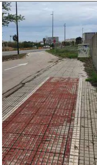
Interrupción del tramo 2 al llegar a la carretera CV-605
