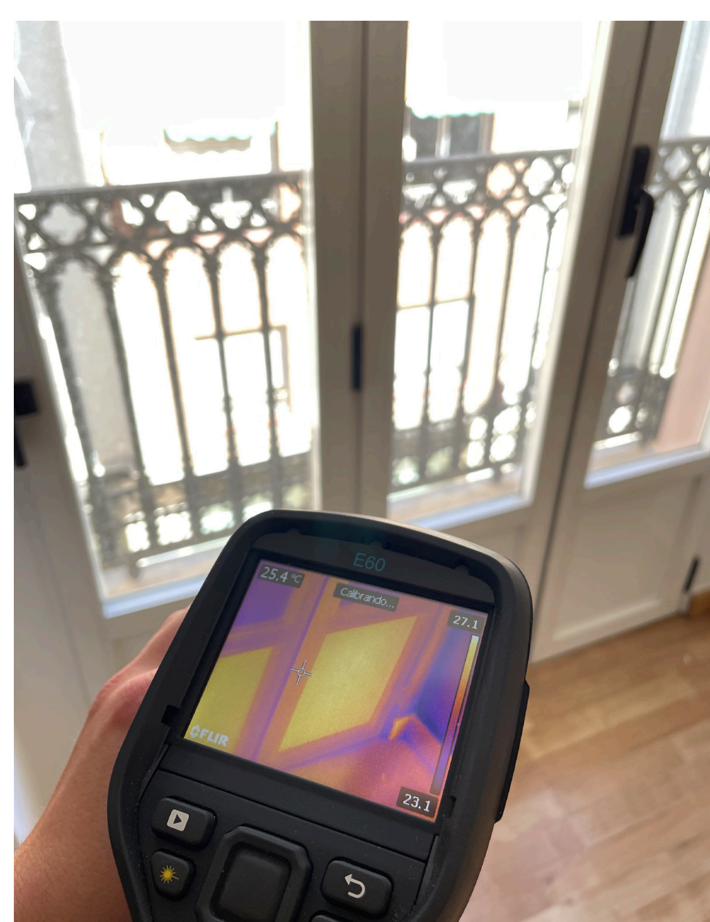
Piloto demostrador. Termografías obtenidas durante la realización del ensayo “Blower Door Test”
