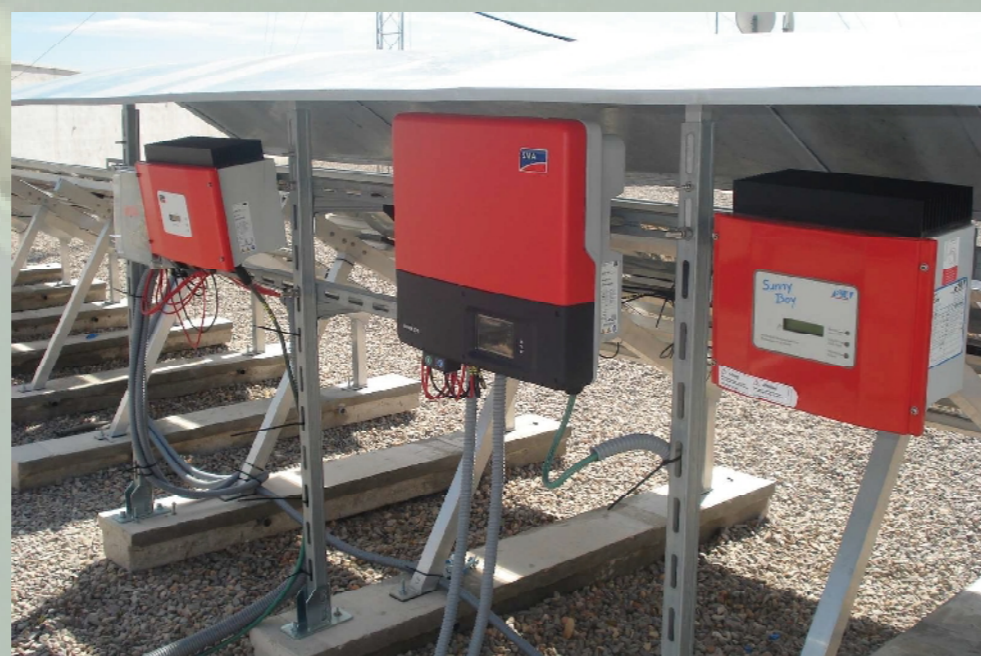
Figura 1. Detalle de los inversores y monitorización
