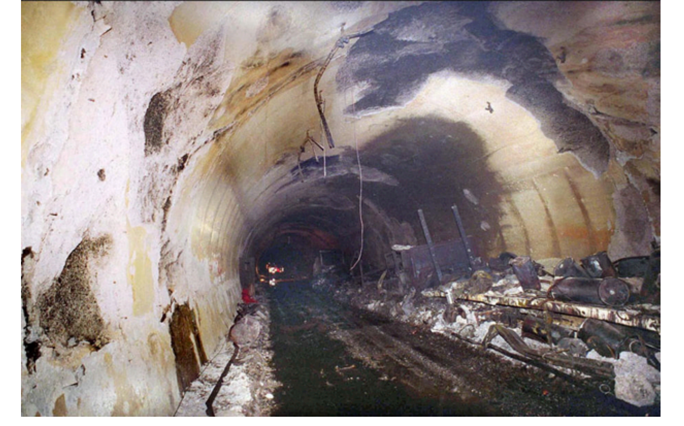
Incendio en túnel Mont Blanc 2001
