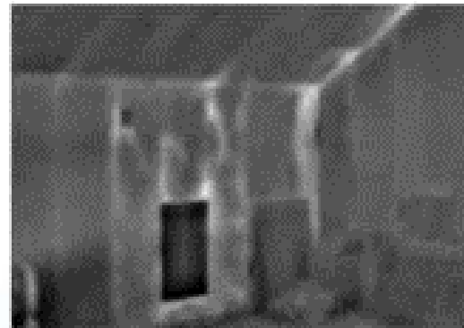
Conductos de termitas vistos con infrarrojos
