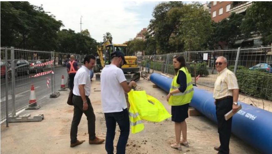
Imagen de archivo de la intalación de nueva tubería en Jacinto Benavente AYUNTAMIENTO -
