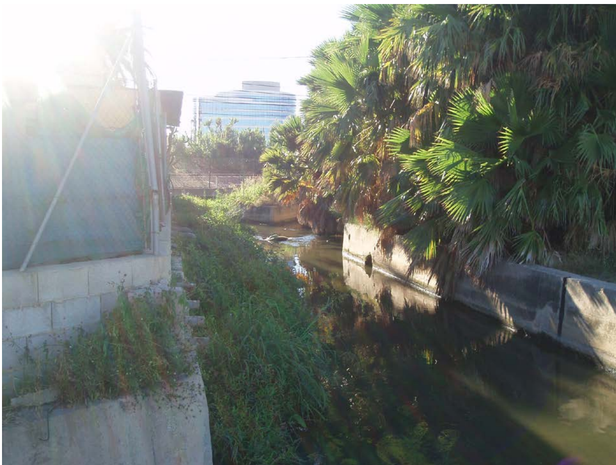
Figura 6.36 Estado actual de la embocadura de la acequia de Vera en el paso bajo el ferrocarril de Barcelona.
