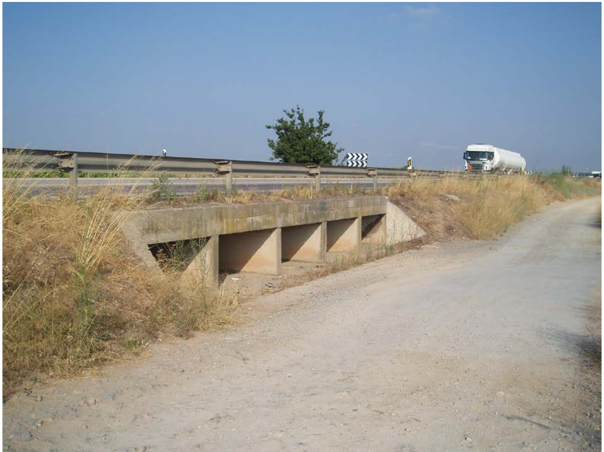
Figura 7.4 Autovía CV-32 Incorporación del drenaje de Museros.
