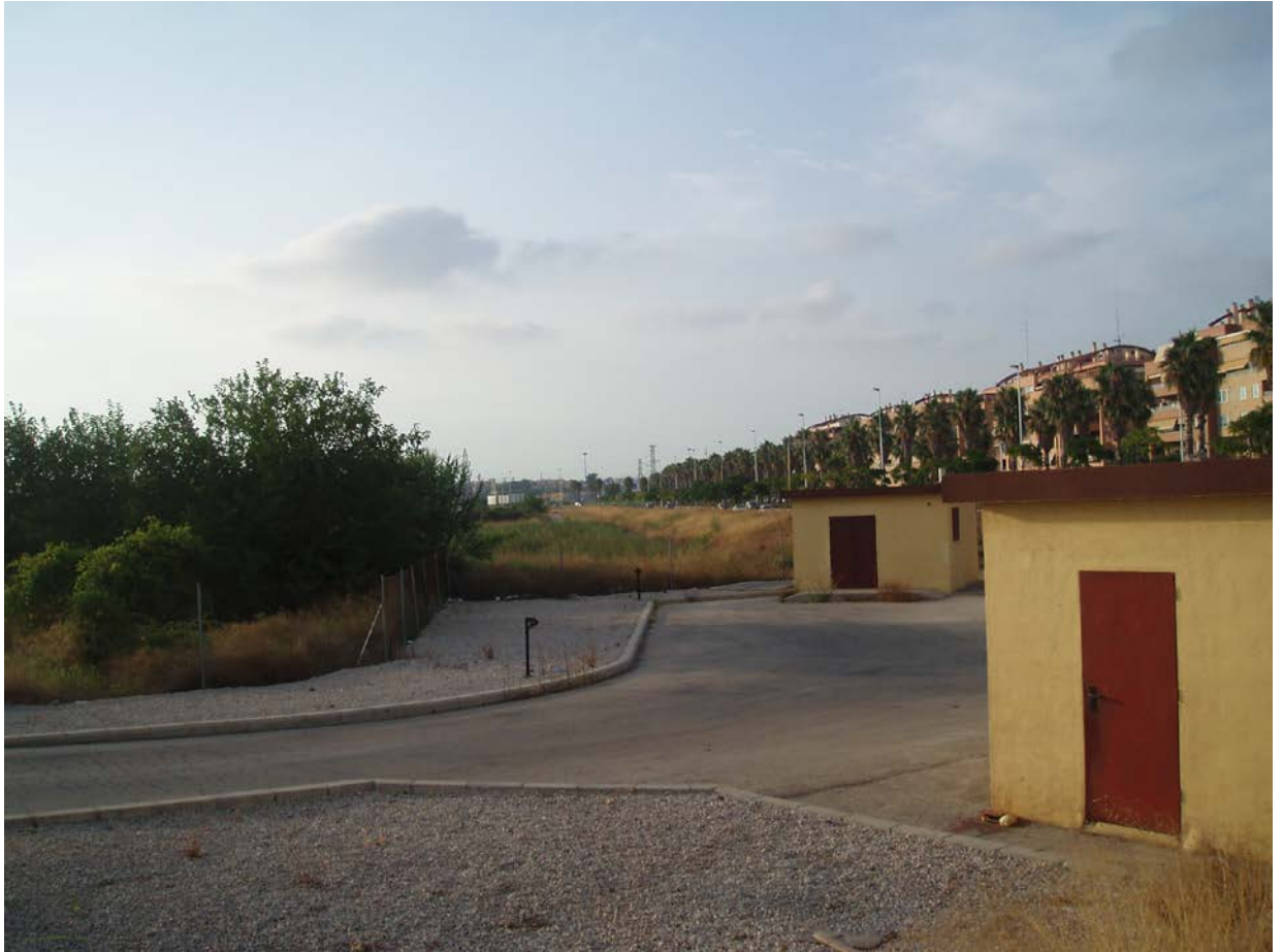
Figura 7.23 Instalaciones de entrada y aliviado al colector de la acequia de Mestalla.
