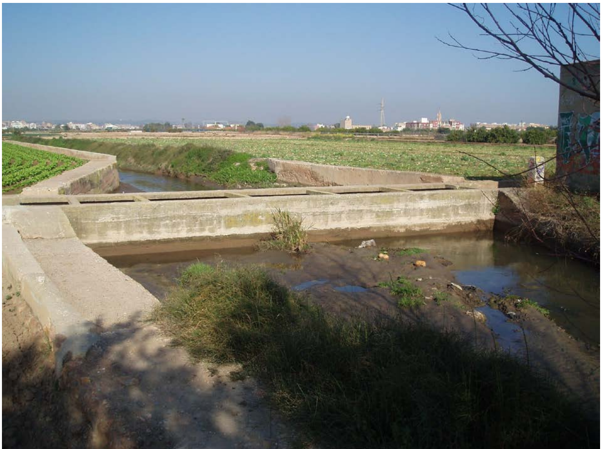
Figura 6.28 El “Anell” de Carpesa. Paso bajo la acequia de Rascanya de la Acequia de Vera. Obsérvese su estado de obstrucción.
