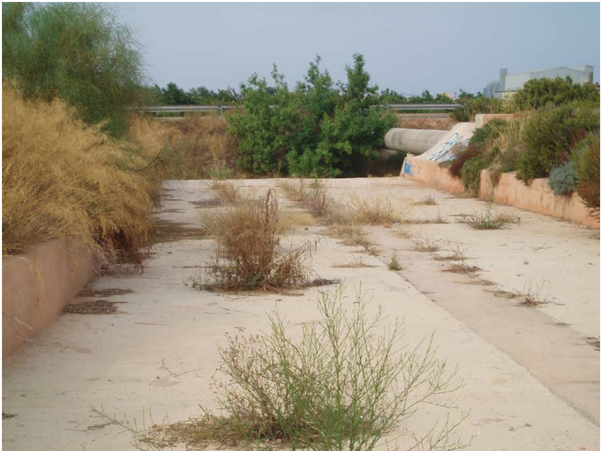
Figura 6.26 Aliviadero de la Acequia de Vera al Interceptor del Palmaret Medio.
