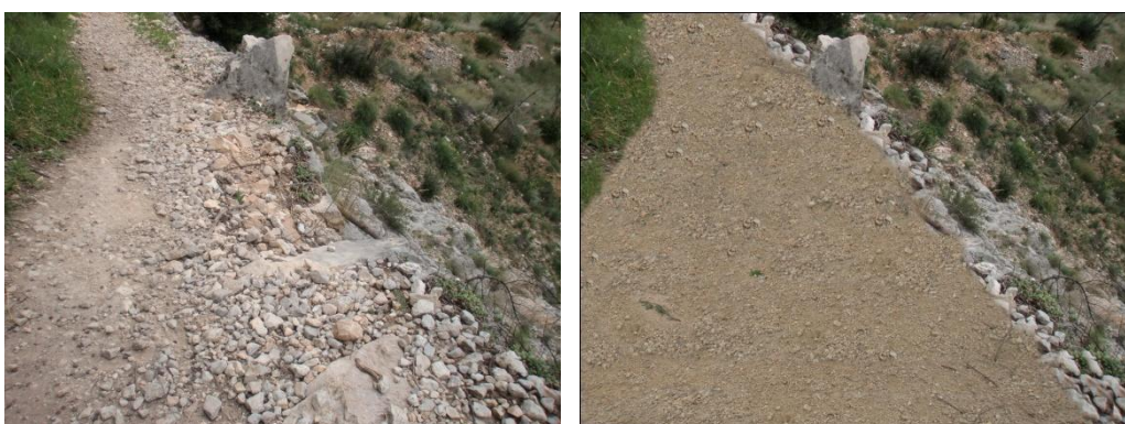
Imagen 5: Senda con colapso.
