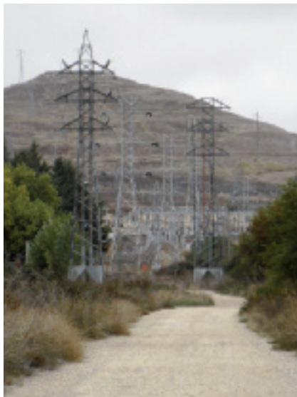
Líneas de alta tensión para Villagonzalo Pedernales
