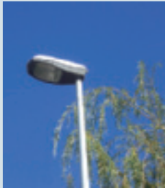
Luminaria de vapor de sodio
