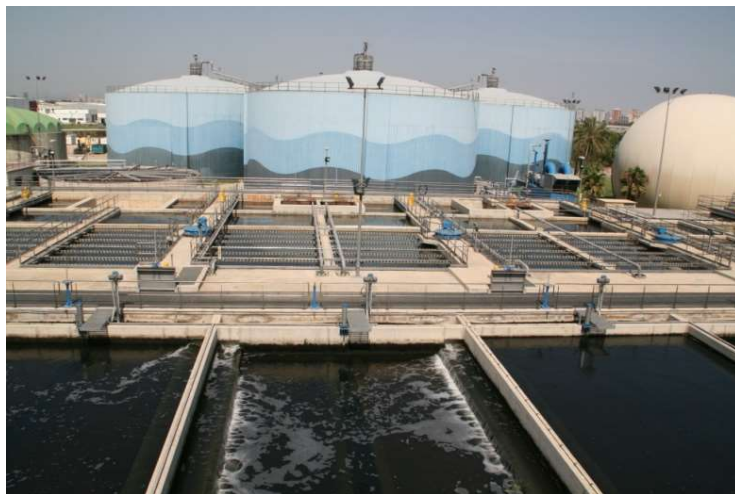
EDAR Pinedo. Filtración en arena
