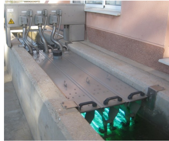
EDAR Sueca. Desinfección UV
