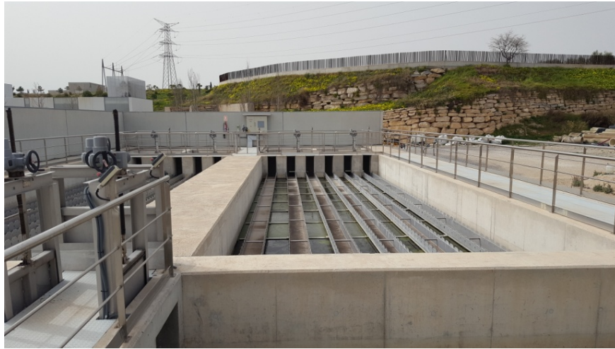
EDAR Alacantí Norte. Decantación lamelar
