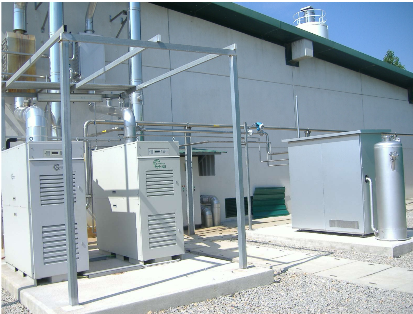
EDAR Paterna – Fuente del Jarro. Microturbinas (2 X 65 kWe)
