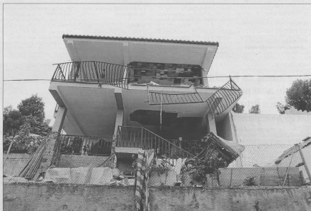
DESTRUCCIÓN. La explosión se produjo en la última planta del chalé donde se encontraba la familia, y destruyó tabiques, paredes y barandillas.
